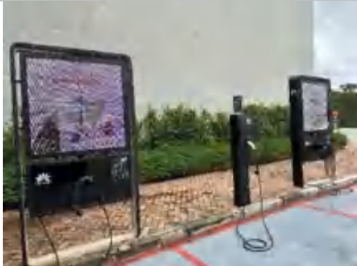
Carregadores para veículos elétricos
