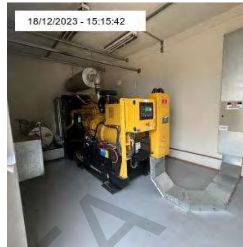
Casa de maquinas
