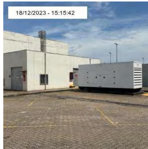
Casa de maquinas
