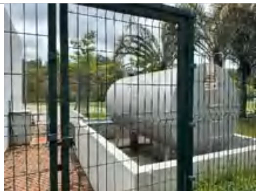
Tanque diesel do gerador
