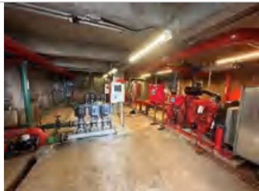
Central de bombas
